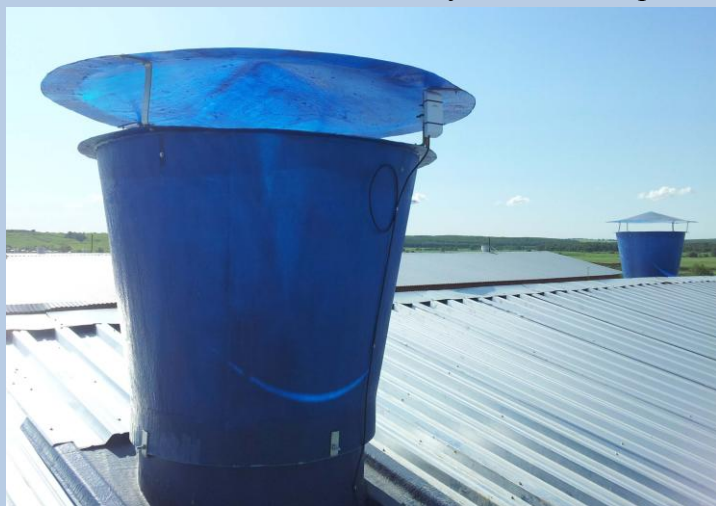
Крепление точки-доступа Wi-fi производится на приточную шахту.
